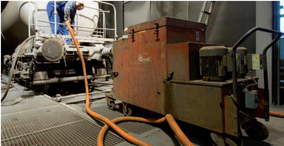
Der DS 4000 in einem Betonwerk Brühl
